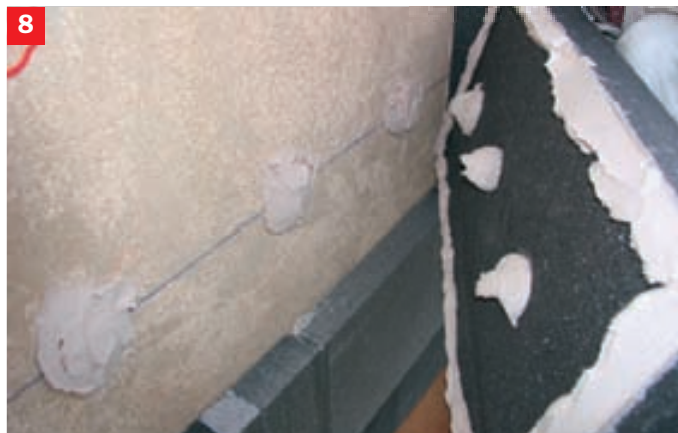
8. Na zadní stranu každé tepelně izolační desky se nanese ve formě okrajového pásu a tří středových terčů vrstva lepidla tak, aby výsledná plocha slepu byla min. 40%. Desky se způsobem „čerstvé do čerstvého“ osadí na ploše s ještě nezatuhlým lepidlem na talířích Baumit StarTrack.
